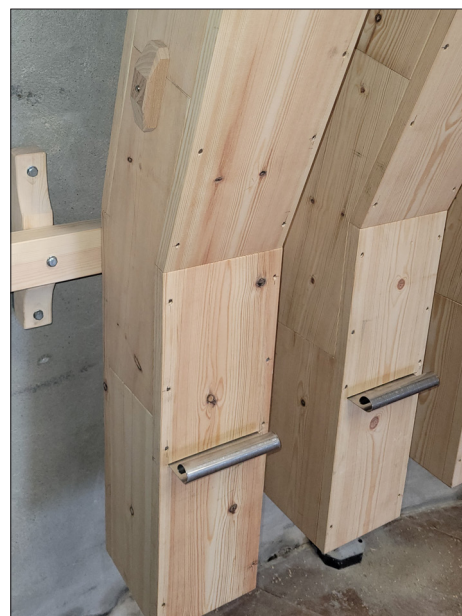
De nieuwe pijpen met onderaan afsluitschuiven
