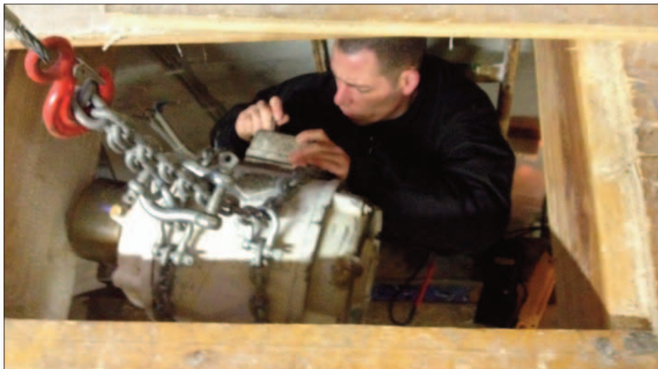
De electriciën koppelt de motor af
